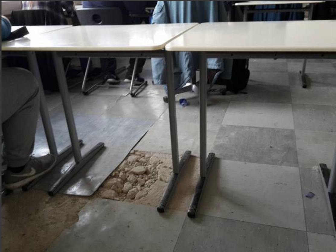
24 - Carreau de dalle linoleum manquante au sol
