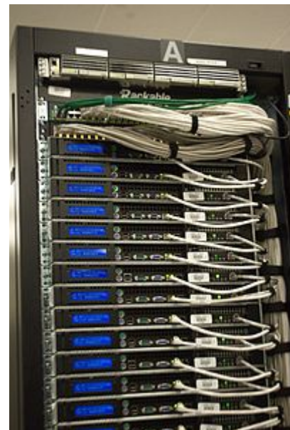
Centre de stockage des données.
